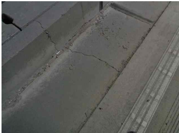
포장부 S01 균열-서울방향
