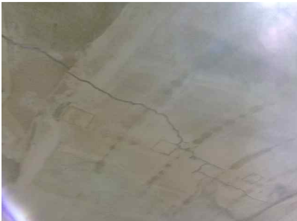
라이닝 S28 천단부 재균열(Cw=0.3mm이상)-서울방향
