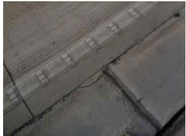
포장부 S32 파손-문산방향
