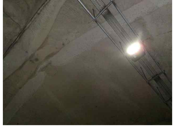
라이닝 S08 천단부 균열(Cw=0.3mm이상)-서울방향
