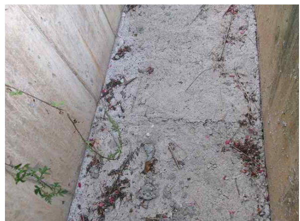
중점측 갭문 균열( C_w=0.3\text{mm} 미만)-문산방향
