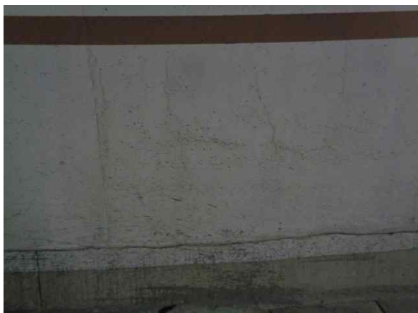
라이닝 S28 측벽부 망상균열-문산방향
