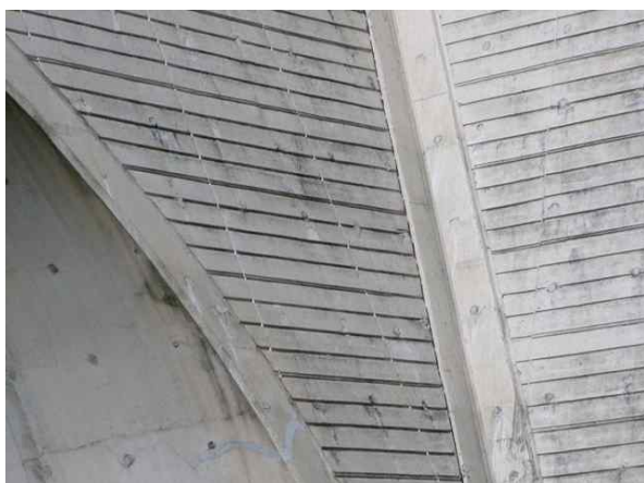
시점측 갭문 망상균열-문산방향
