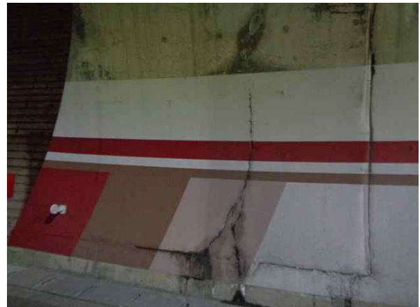
라이닝 S01 측벽부 균열부 누수-서울방향
