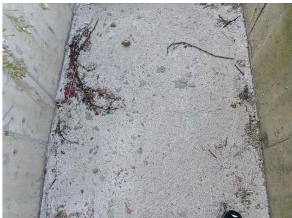
중점측 갭문 균열( Cw=0.3\text{mm} 미만)-서울방향
